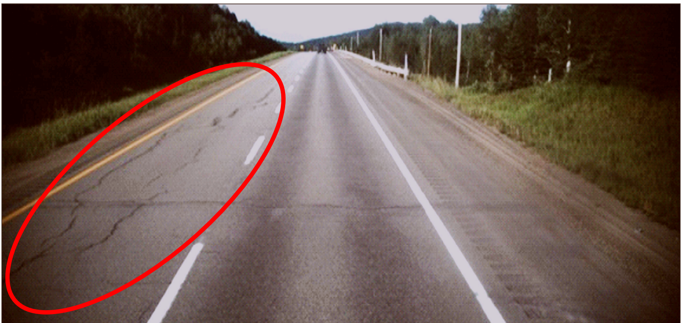
Figure 2 – Chaussée SANS infrastructure améliorée : route 175, fissuration prématurée
